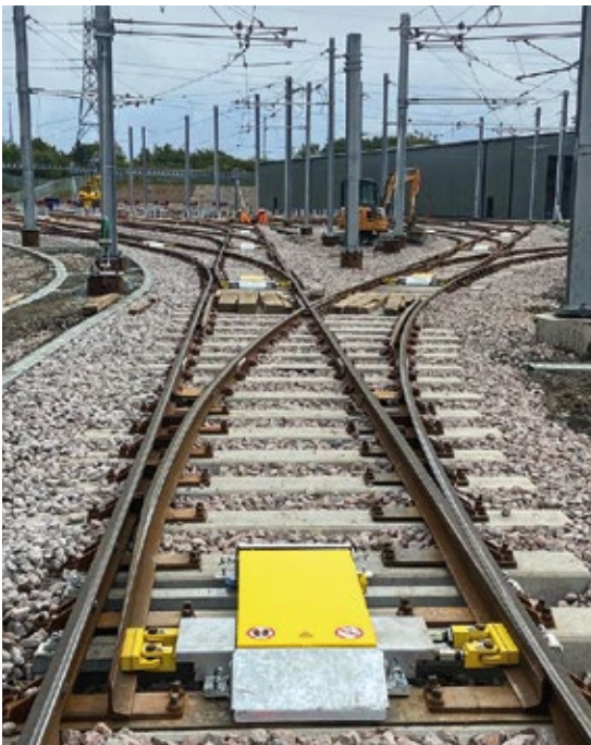
Zehn Weichenantriebe auf einen Streich im Howden Depot, UK. Ten point machines in one go at Howden Depot, UK.
