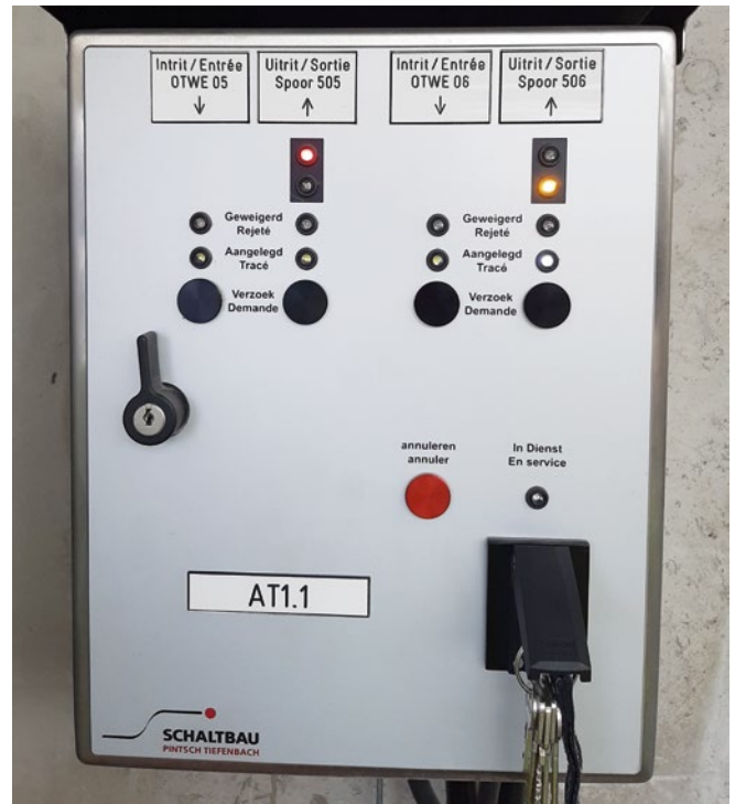
Bild 5: Hallenstelltafel für die Nahbereichssteuerung
