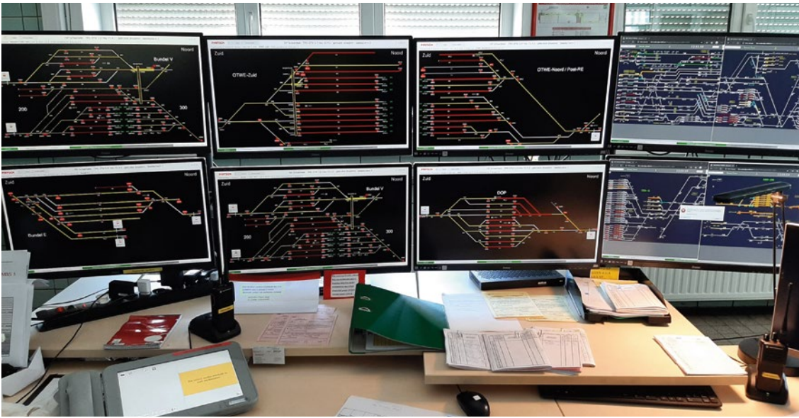
Bild 1: Bedienplatzsystem des Rangierstellwerkes ISP Schaarbeek
