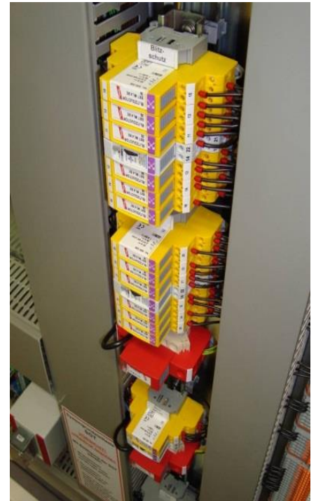
Blitzschutz auf KAG
